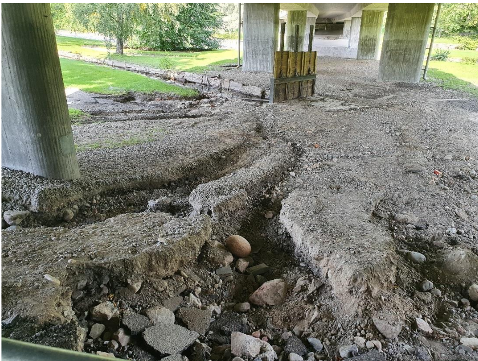
Figur 23. Erosion under Kvarnbron, Gävle. Foto: Christoffer Carstens.
